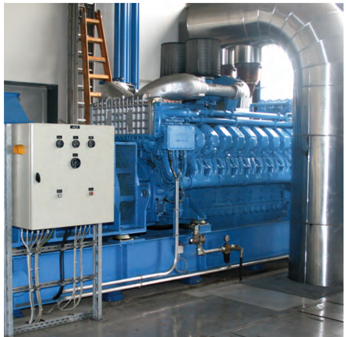
Notstromversorgung eines Unternehmens, Vier MAN-Dieselmotoren werden bei Stromausfall mit Druckluft gestartet und können die wichtigsten Bereiche mit Strom versorgen
