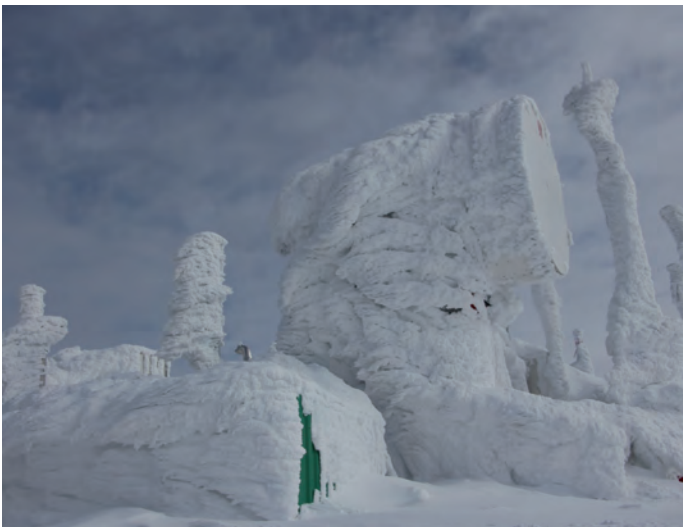
Sendeanlagen müssen auch unter extremen Bedingungen funktionieren. (Bild: Sendeanlage in den niederösterreichischen Kalkalpen im Wintergewand)
